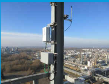
Gateway installation Dow Stade
